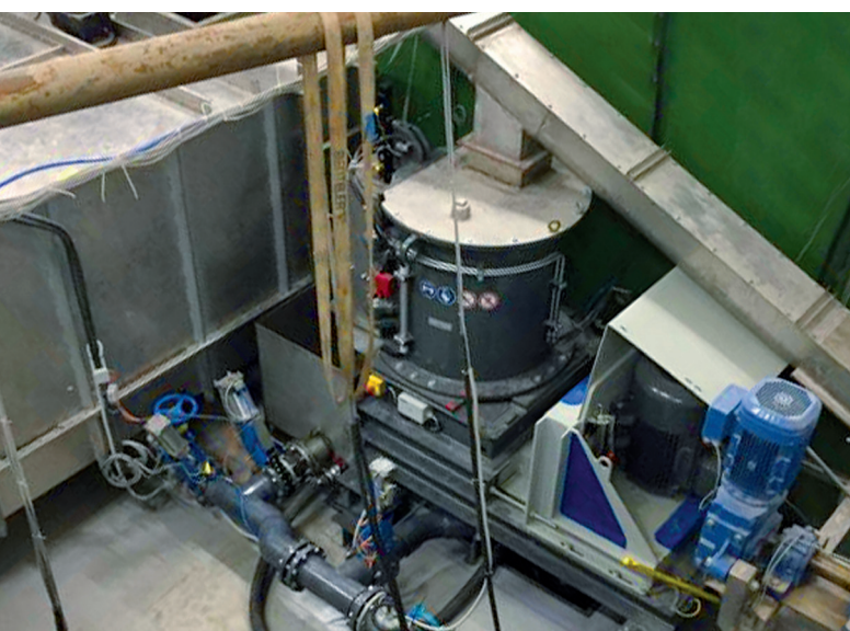
Anbindung des THM Querstromzerspaners Type Bio-TQZ900 in der Anlage
