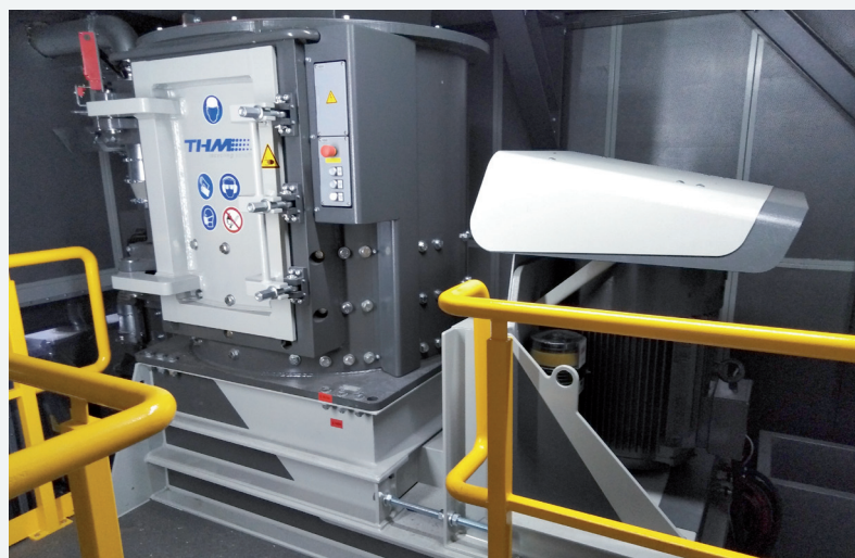
TQZ1200 in einer Schallschutzbox installiert
