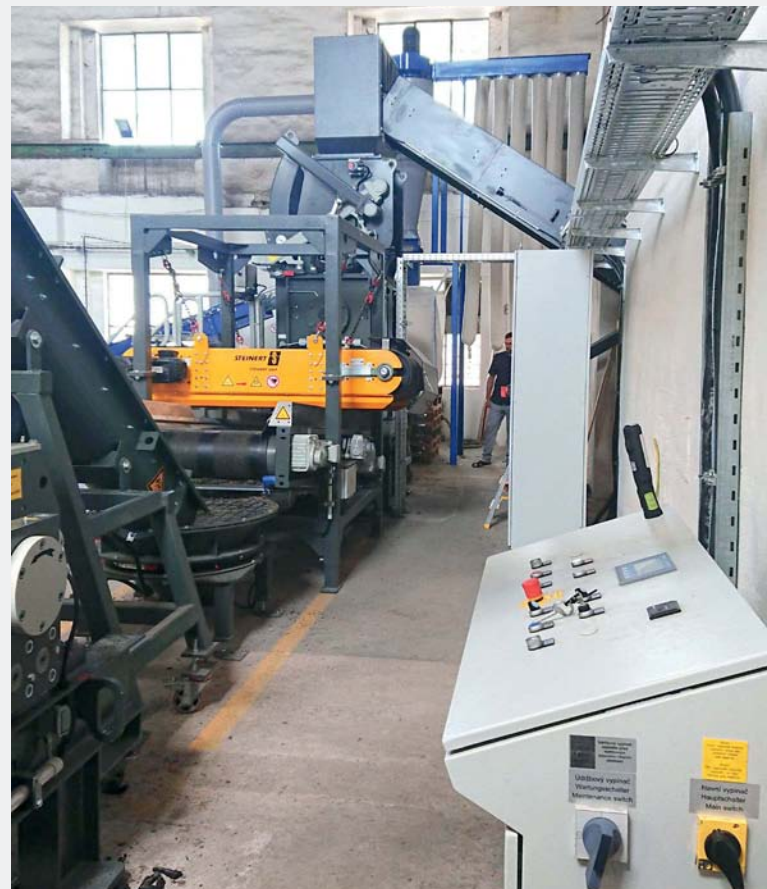
Installierte Anlage bei S-Firma
